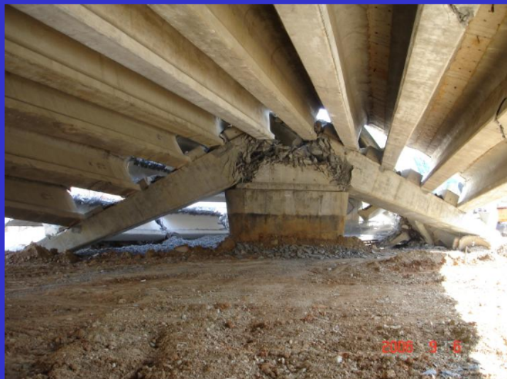
Вид разрушенной опоры моста в г. Екатеринбурге
