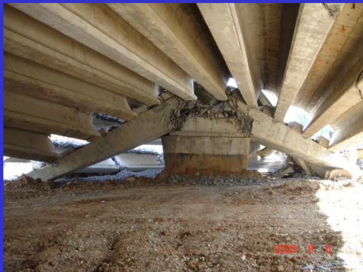
Вид разрушенной опоры моста в г. Екатеринбурге
